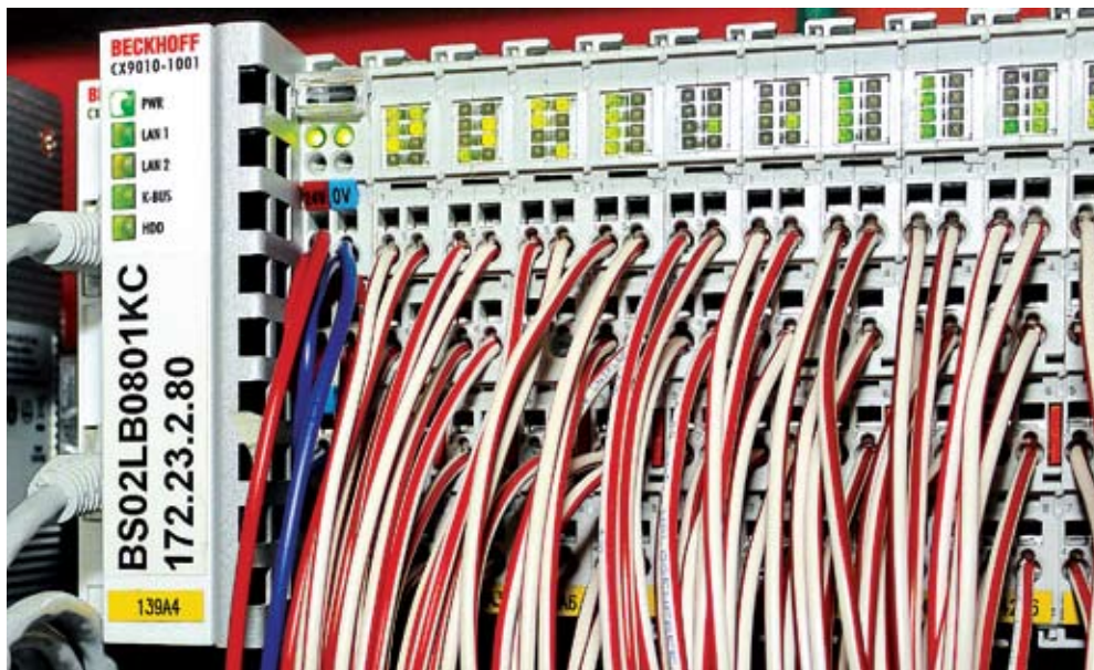
Рис.2 Сигналы, поступающие на датчики и исполнительные механизмы и идущие обратно, передаются с помощью модулей ввода/вывода Beckhoff и обрабатываются контроллером CX9010. Взаимодействие между системой, другими подстанциями и программной системой диспетчерского управления и сбора данных (SCADA) осуществляется через Ethernet с использованием оптоволоконных кабелей.
